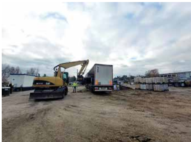
• Składowisko przy ulicy Składowej zostało już prawie uprzątnięte.
